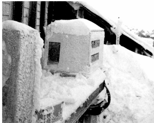
Extreme Bedingungen im Winter für die Wärmepumpe
