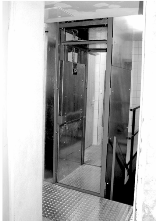
Lastenaufzug in den Keller
